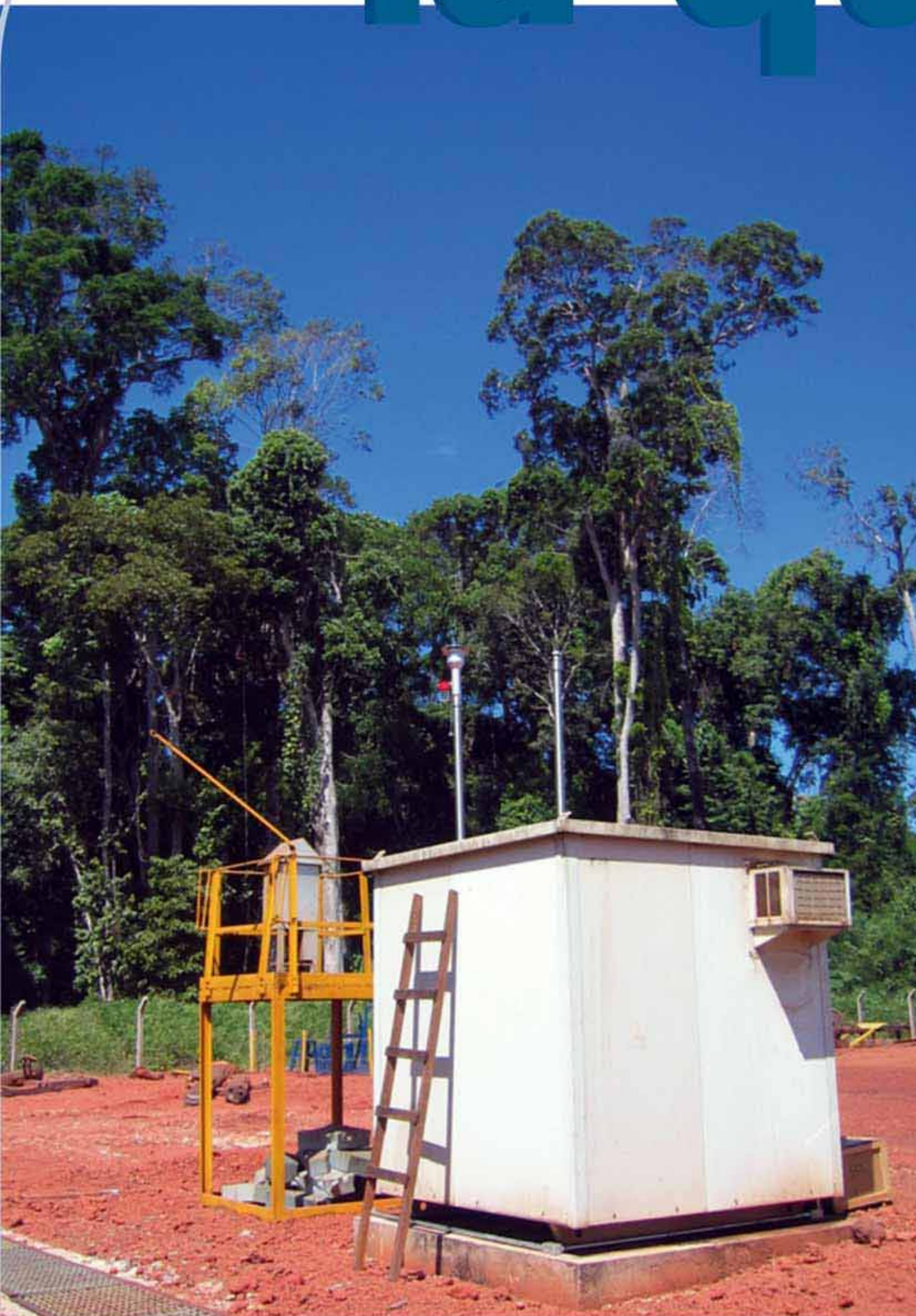
Station de contrôle de la qualité de l'air. 4 stations identiques seront installées autour de l'usine de Goro Nickel
